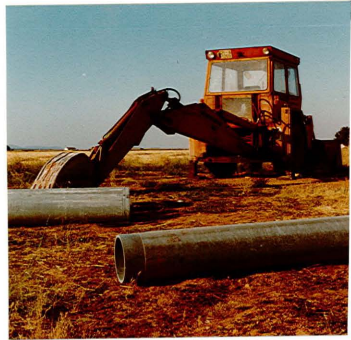
LA ESCAVADORA REPOSA TRAS REALIZAR LA ZANJA PARA LA TUBERIA DE EMPALME
