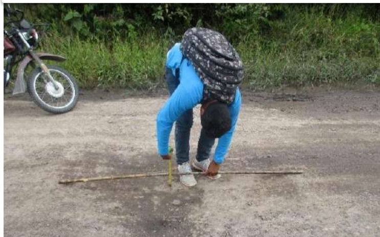
Medición de una deformación en vía Calzada –Sector Sunisacha
