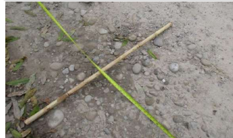
Medición de un bache en vía Emp. PE-8B (Calzada) – Sector Misho
