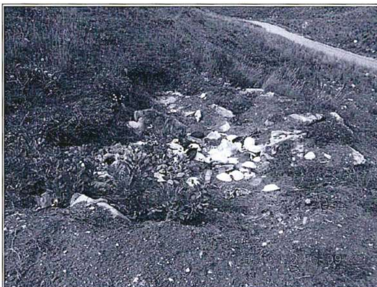
FOTO N° 57: Vista de los residuos sin encapsulamiento o manejo alguno. No se observa la impermeabilización con arcilla compacta, ni la capa de cemento de 5 cm de espesor.
