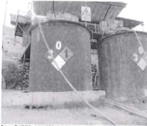
Fotografía N° 039: HALLAZGO N° 01. Nótese que la base del sardinel se encuentra deteriorada.
