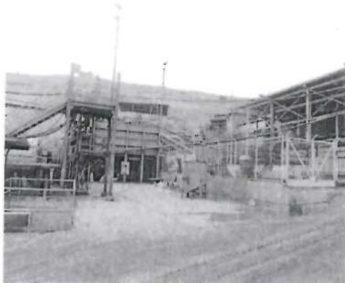
Fotografía N° 050: HALLAZGO N° 02. Nótese que el extremo de la plataforma de concreto no cuenta con un sistemas de colección y conducción del aguas residual.
