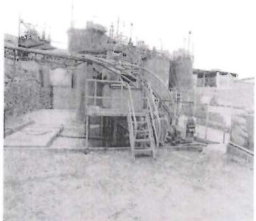
Fotografía N° 057: HALLAZGO N° 03. Estación de bombeo de relaves, desde este punto se bombean los relaves hacia el depósito ubicado en la parte alta.
