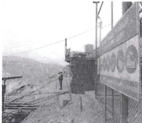
Fotografía N° 031: HALLAZGO N° 01, Tal como se aprecia en la imagen, el tanque de preparación carece de un sistema o medio que le permita contener y recuperar los posibles derrames de solución de cianuro de sodio.
