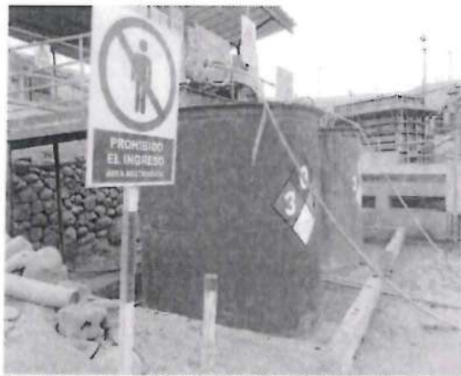
Fotografía N° 036: HALLAZGO N° 01, Tanque de almacenamiento de Soda Caustica y cianuro de sodio; la estancia se encuentra abierta y no tiene la capacidad del 110% del tanque de mayor capacidad.
