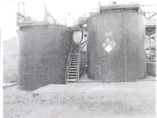
Fotografía N° 051: HALLAZGO N° 02. Tanques de cianuración, nótese en los extremos la plataforma de concreto la falta de un sistema que permita colecto conducir las aguas de lavado de pisos y equipamiento.
