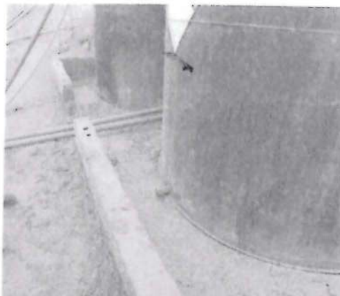
Fotografía N° 038: HALLAZGO N° 01, El sistema de contención se encuentra abierto y no cuenta con la capacidad del 110% del volumen del tanque de mayor capacidad.
