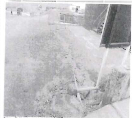
Fotografía N° 053: HALLAZGO N° 02. Este tramo, corresponde a la zona de los tanques de cianuración, nótese que el agua corre sobre el suelo debido a la falta de un sistema de colección y conducción.
