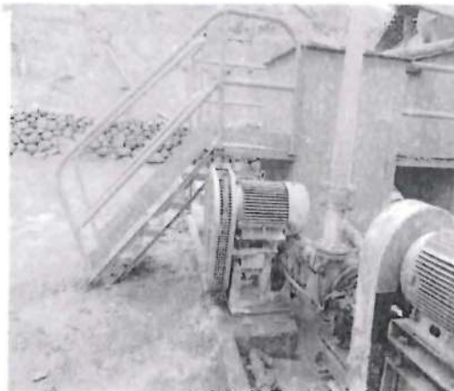
Fotografía N° 060: HALLAZGO N° 03. Debido a que el sistema de bombeo está instalado en el extremo de la plataforma de concreto, la pérdida de agua residual durante la operación y/o mantenimiento no puede ser contenida por el sardinel (medio de contención).
