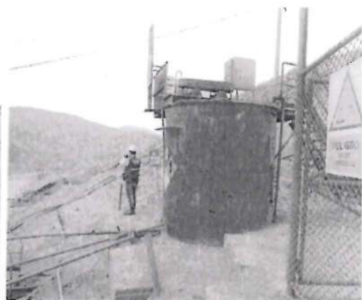
Fotografía N° 030: HALLAZGO N° 01. Tanque metálico de preparación de solución de cianuro de sodio, capacidad 10 m³, se encuentra apoyado sobre una base de concreto.
