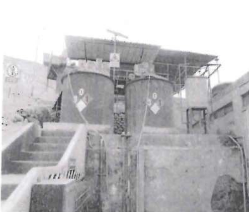
Fotografía N° 037: HALLAZGO N° 01, Tanque de almacenamiento de solución de Soda Caustica y Cianuro de sodio se ubican en la parte alta.
