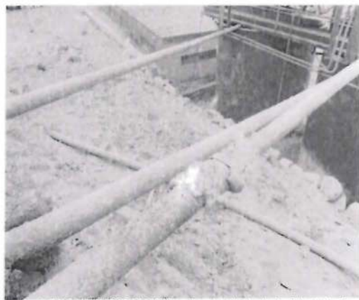
Fotografía N° 032: HALLAZGO N° 01, Línea de conducción de solución, interconecta el tanque de preparación y tanques de almacenamiento de solución.
