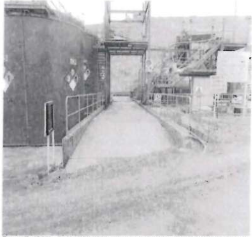
Fotografía N° 049: HALLAZGO N° 02. Nótese que el extremo de la plataforma de concreto no cuenta con un sistema de colección y conducción para el agua residual.
