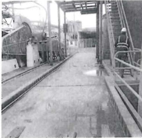
Fotografía N° 048: HALLAZGO N° 02. En la losa de concreto, se observa presencia agua residual industrial, dicha agua se genera durante el lavado pisos y equipamiento de la planta de procesos.
