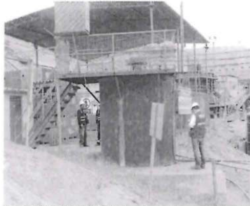
Fotografía N° 034: HALLAZGO N° 01, El Tanque de preparación, carece del sistema que le permita contener y recuperar los posibles derrames de solución cianurada.
