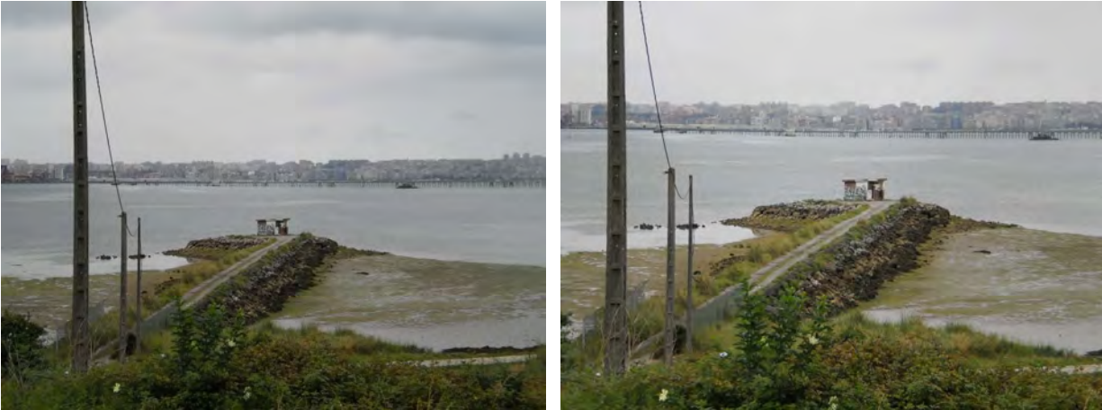
Figuras 50 y 51. Vista general y detalle del estado del Recinto 4.
