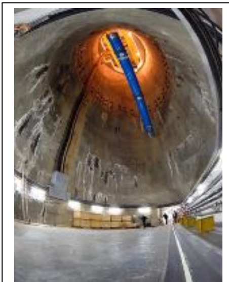
Fig.3. Imanes dipolares del LHC descendiendo a 100 m de profundidad para su instalación. Fuente: CERN.
