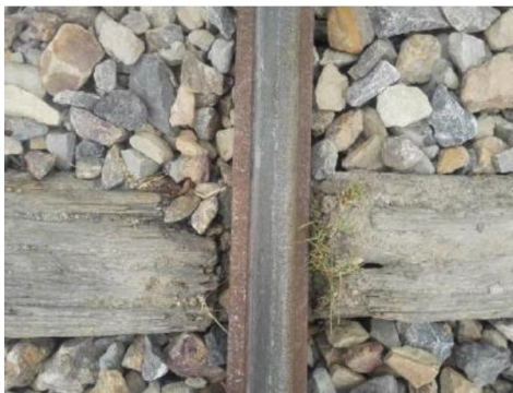
Figura 17 Rompimiento de madera
