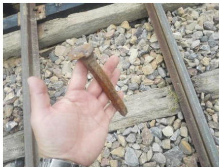
Figura 16 Defecto de no fijación en el durmiente
