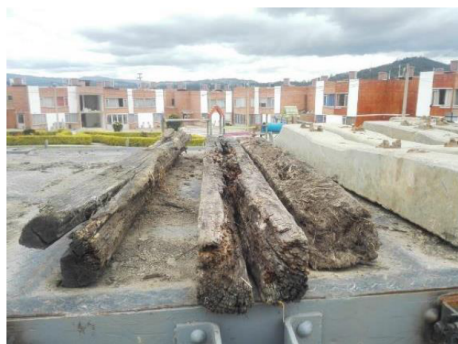
Figura 14 Pudrición del durmiente de madera
