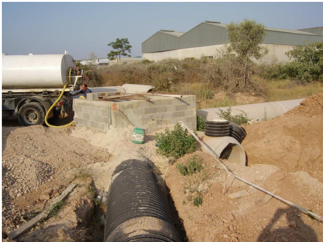
Obras de entubamiento y desvío de la Acequia de El Campés en 2009.
