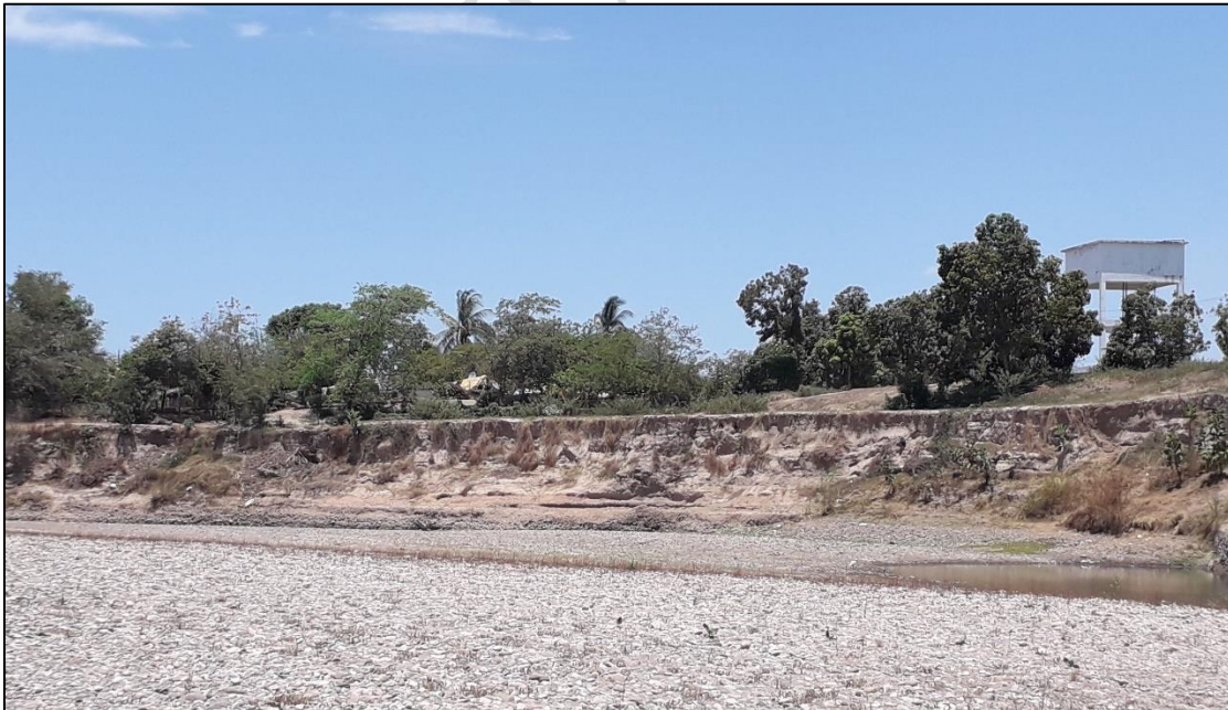
Fotografía 2. Talud del río erosionado donde se formaran los bordos cercanos a la localidad “Laguna de Beltranes”.
