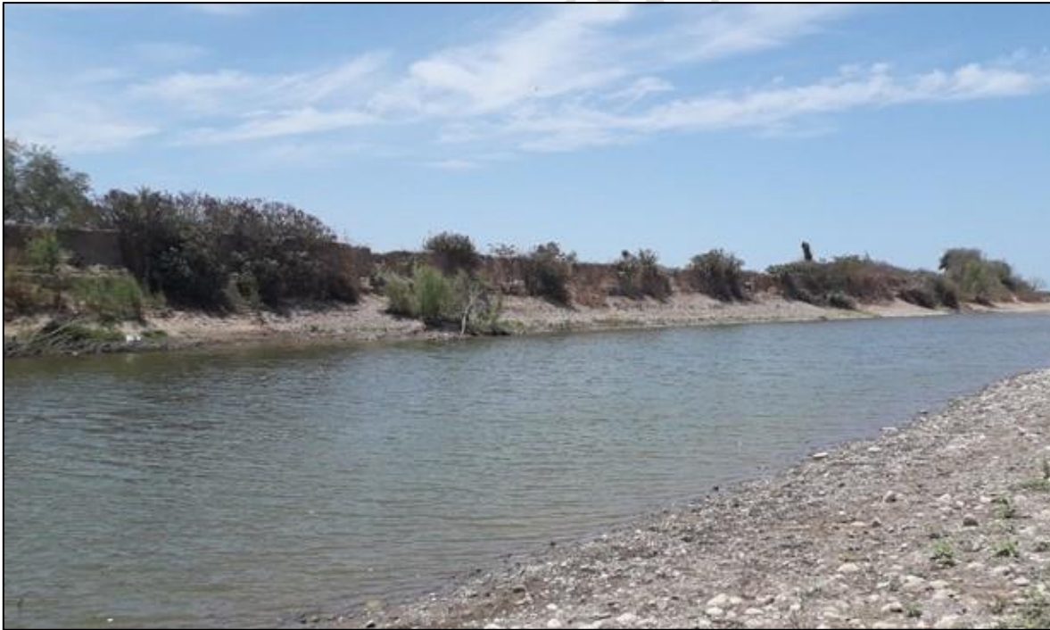
Fotografía 7. Muestra la erosión en los taludes debido al azolvé del río afectando los terrenos colindantes de la margen izquierda agua debajo.
