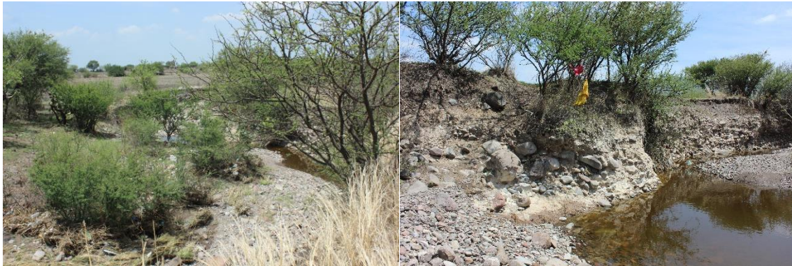
FIGURA 22. Arroyo Barrón y sus procesos de erosión.
