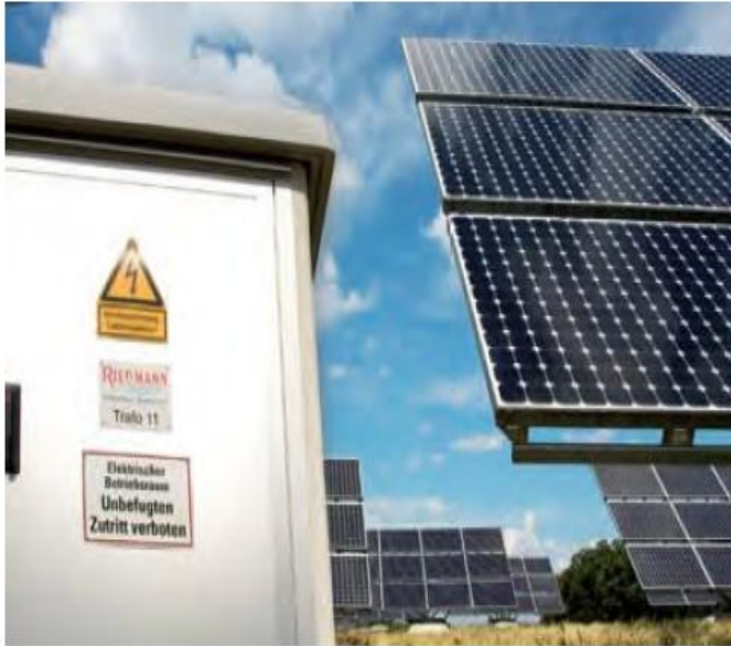
Figura II. 4.- Los Sistemas fotovoltaicos de gran escala alimentan comúnmente su salida a un transformador que convierte la energía a un nivel de mediana tensión.
