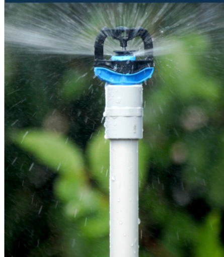
Instalación permanente de microaspersor rosca macho NPT 1/2" en PVC 1/2"
