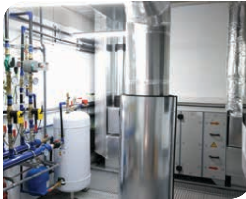
▲ Sala de instalaciones con recuperadores.
