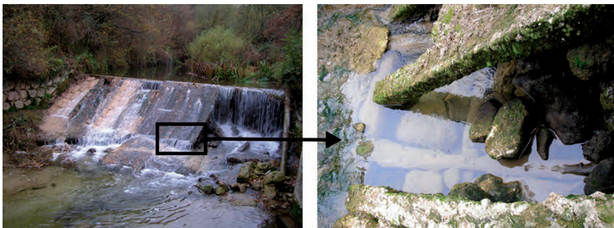
Figura 232; Presa conservada en precarias condiciones en Villanueva de Valdegovia, molino de La Sebe. Fábrica mixta en cordones de piedra labrada y viguería lignaria que se alternan, con morfología similar a un tejado de doble vertiente. En la fotografía de detalle se puede observar la cimentación sobre un emparrillado artificial horizontal de vigas y relleno interior de grandes mampuestos, que sostiene la estructura. Fuentes: elaboración propia; fotografías correspondientes a la intervención arqueológica de finales de 2009.
