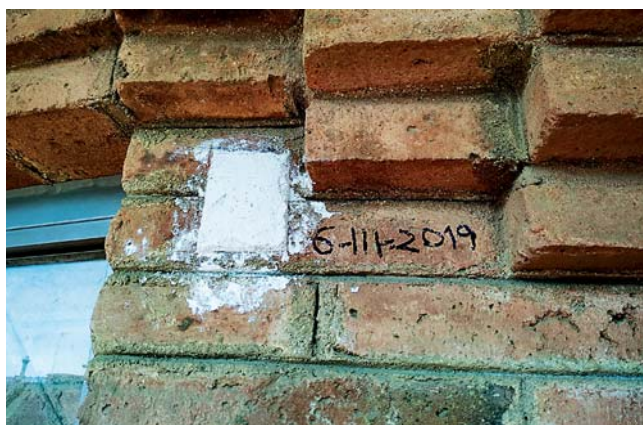
Figura 16. Testigos en fisuras preexistentes exteriores.
