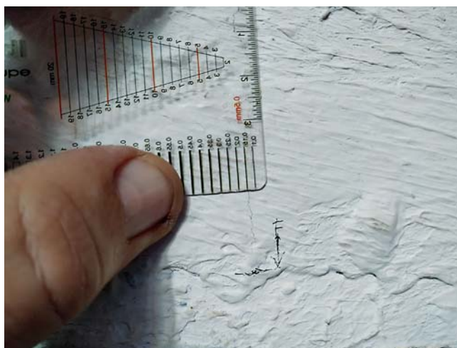
Figura 15. Comprobación de fisuras preexistentes interiores, en pleternas de apoyo de truss.
