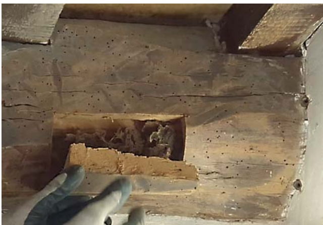
Fig. 2. Obertura d'una finestra a l'albeca per descobrir danys ocults.
