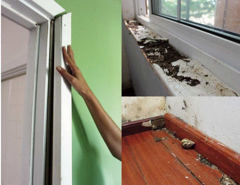
Plaintes ou boiseries qui tombent, murs rongés ou spongieux... Les dégâts liés aux infiltrations ou aux insectes, sont visibles aux quatre coins de la maison.
