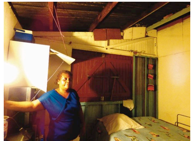
La toiture et l'installation électrique sont à refaire.
