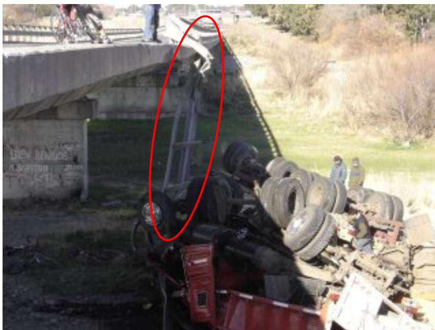
Fotografía 2 – Estado en que quedó la baranda con postes seccionados en su base
