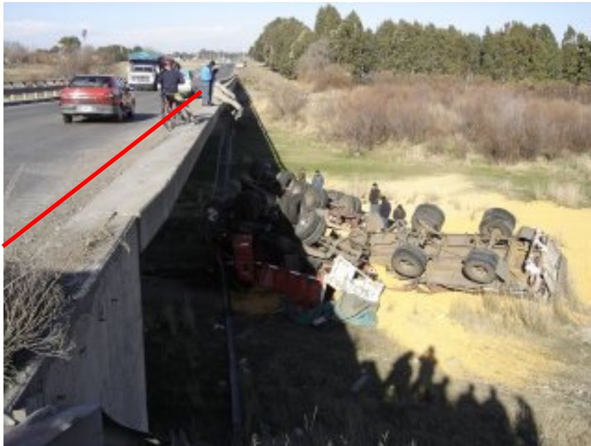
Fotografía 1 – Baranda tipo Flex-Beam barrida por los vehículos
