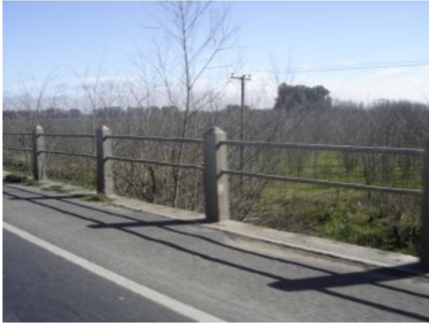
Fotografía 6 - Baranda vehicular y peatonal de postes de hormigón y caños galvanizados sin guardarruedas
