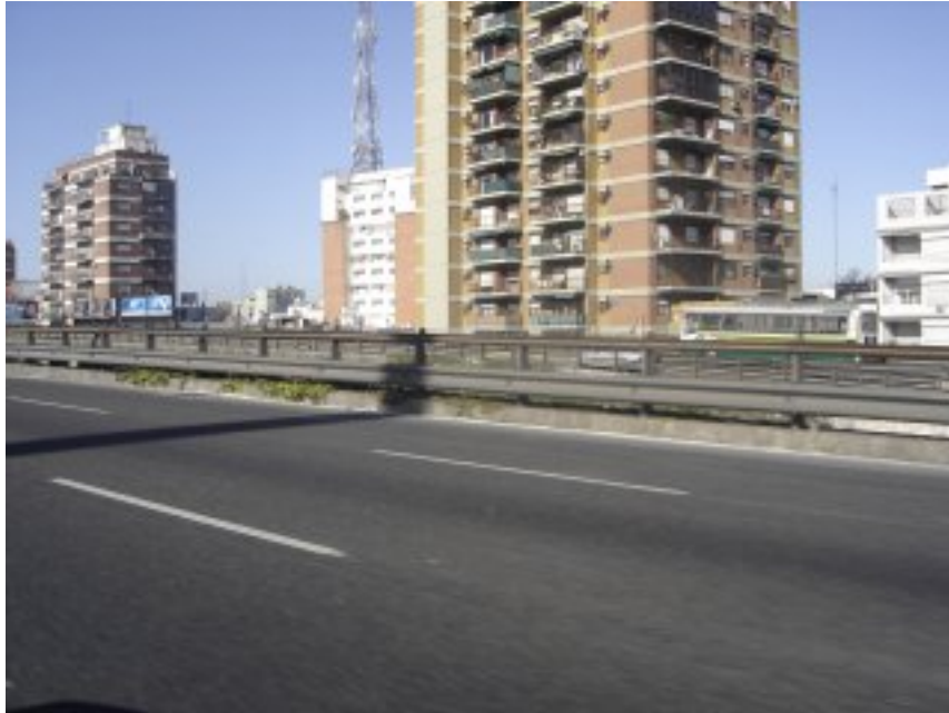
Fotografía 14 – Baranda vehicular metálica tipo flex-beam con guardarruedas
