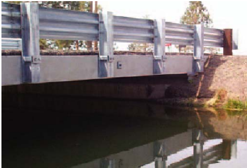
Fotografía 17 – Baranda vehicular metálica con postes y hojas tipo thrie-beam o tri-onda
