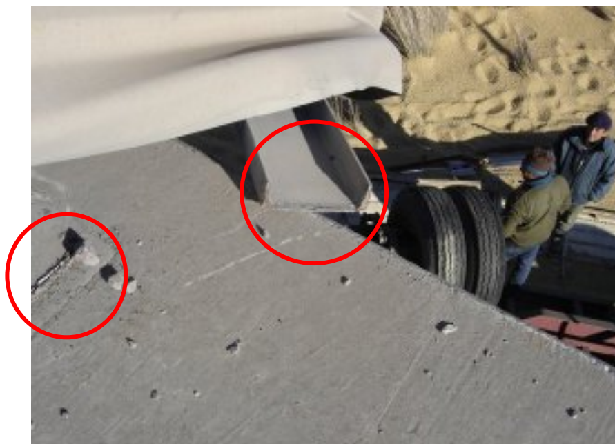
Fotografía 4 – Poste de la baranda seccionado en la soldadura con placa base
