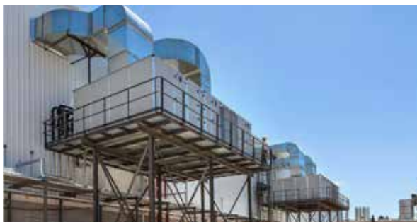
Unidades de tratamiento de aire principales para el depósito controlado con ciclo economizador.
