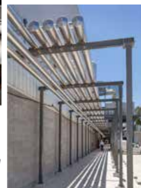
Rack de cañerías de distribución
