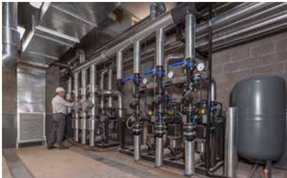
Planta de bombas de frío y calor instaladas
