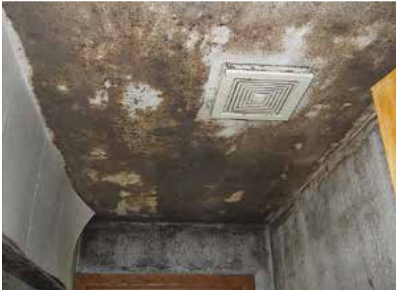
Foto 1. Un cuarto de baño en una casa de WAP en Wisconsin. El ventilador de techo no funciona o no se utiliza. El moho que crece en las superficies es potencialmente peligroso para los ocupantes, algunos de los cuales son niños. Este es el tipo de problema que puede soportar la ventilación y el uso conforme a la Norma 62.2.
