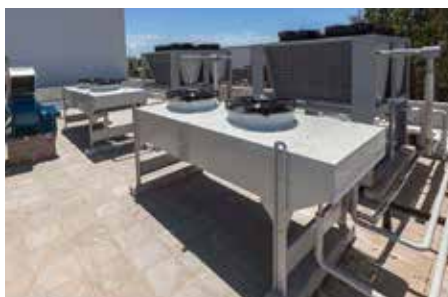
Enfriadores de aceite y de amoníaco sobre la cubierta de sala de compresores
