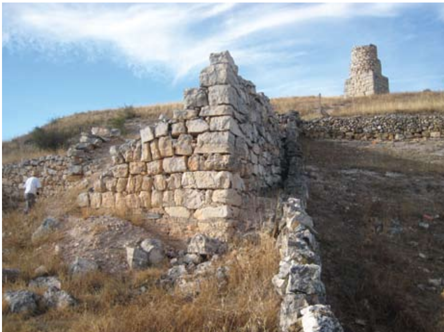
Figura 8. Detalle del esquinazo sudoriental del horno industrial menor, y el más próximo a la torreta-chimenea de la parte superior de la ladera de las Viñas.
