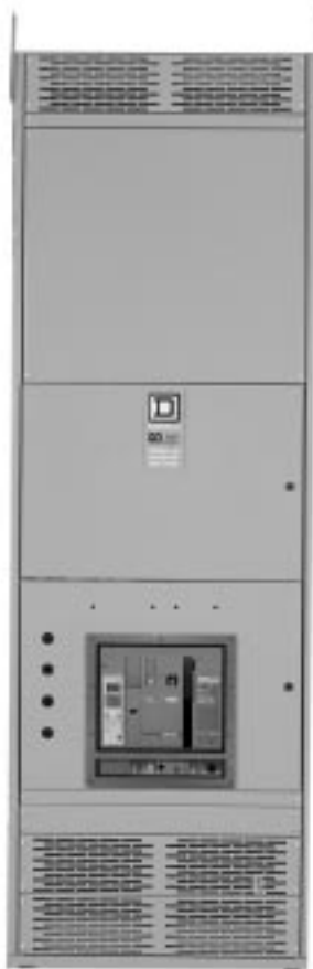
Sección principal con interruptor Masterpact NW
