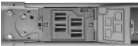
Ventana de conexión del electroducto
