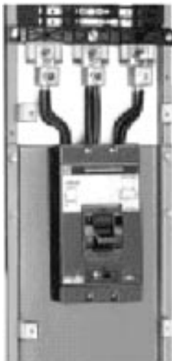
Ensamble del interior con interruptor principal y zapatas de acometida al panel de distribución
