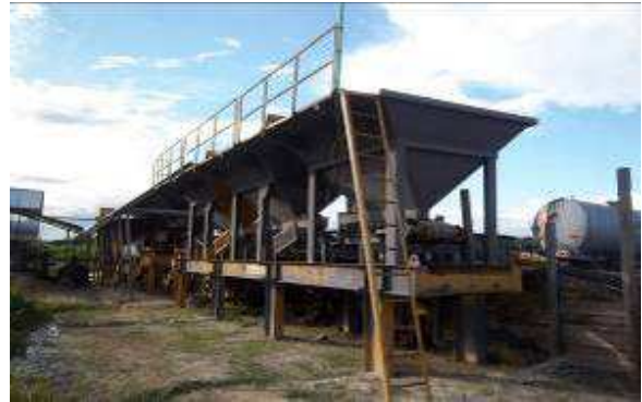
Foto No. 2, Planta de asfalto.
