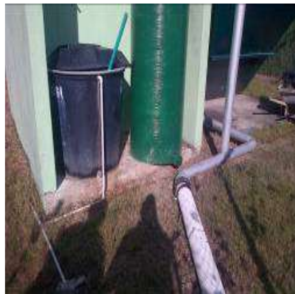
Figura Nro. 5. Tanque de cloración de la PTAR
