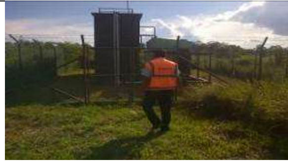
Figura Nro.3 Planta de Tratamiento de Aguas Residuales (PETAR).
