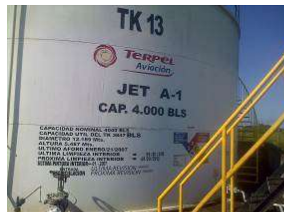
Figura 7. tanque No. 13 de capacidad de 4000 barriles, con combustible JET A1.
