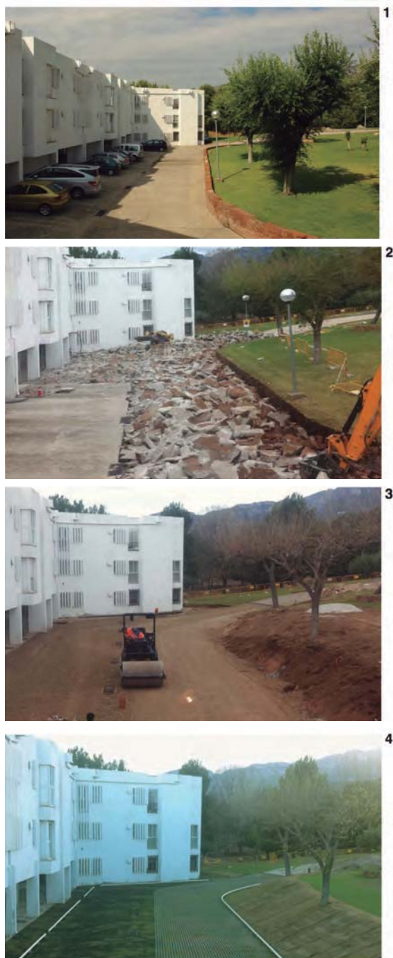
Figura 6. Despavimentar: rehabilitación de plazas hexagonales, mayo de 2013, arquitectos: Juan Fernando Ródenas y José Ramon Domingo (CAIT). Fotografía: Centro de Análisis Integral del Territorio.
