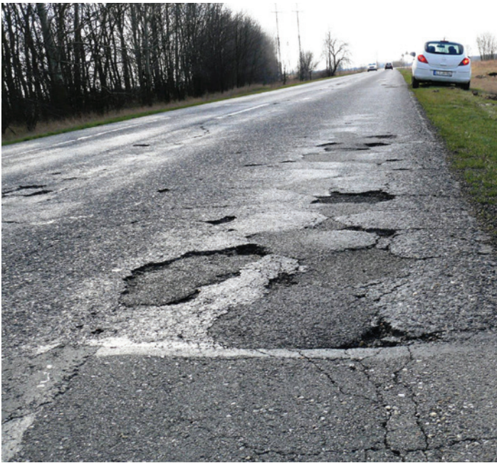
Fig. 2 - Un exemplu de drum deteriorat
