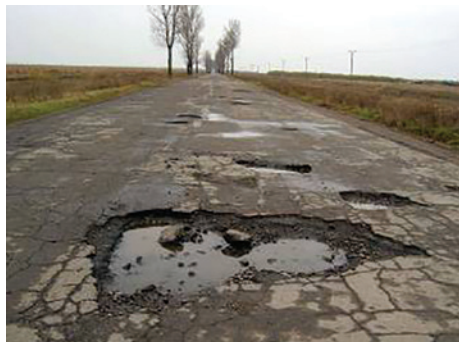
Fig. 1 - Imaginea unui drum județean cu îmbrăcăminte ușoară și durată de exploatare depășită
