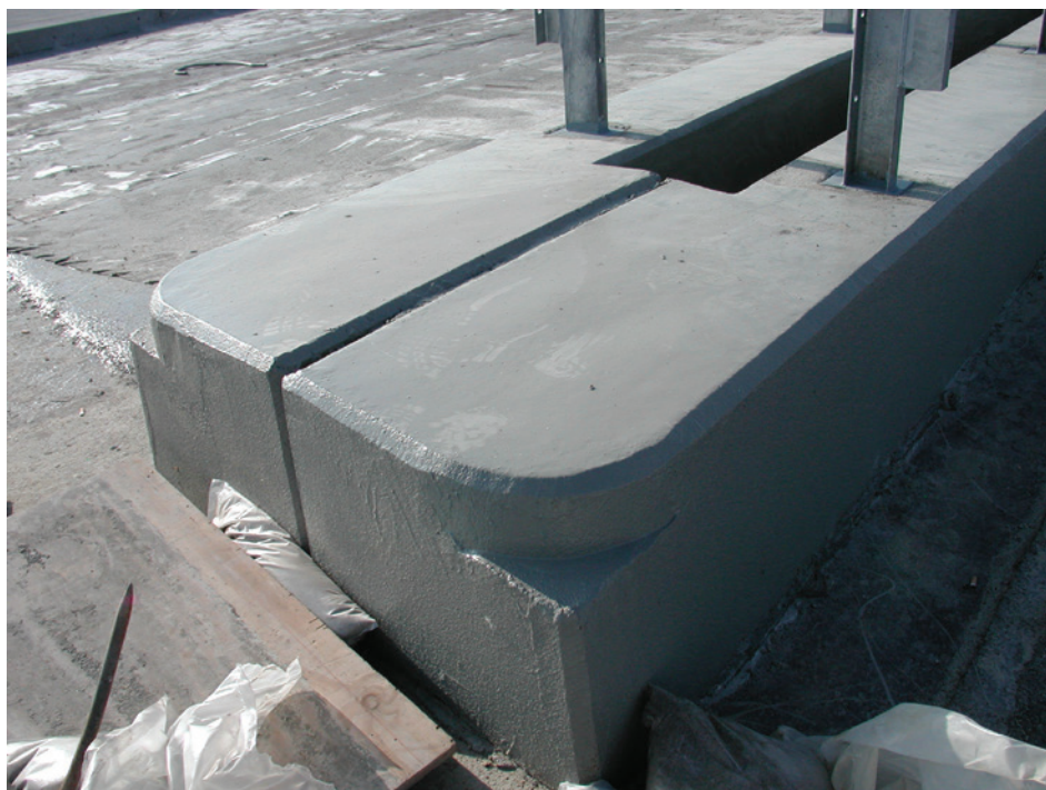
Fig. 1 - Acoperirea cu pelicule protectoare specializate a elementelor lucrărilor de artă direct expuse atacului din îngheț-degheț cu sare reprezintă o măsură foarte eficientă de prelungire a duratei de viață (foto 2005, Șoseaua de Centură M0 cu profil de autostradă, Budapesta, Ungaria)
