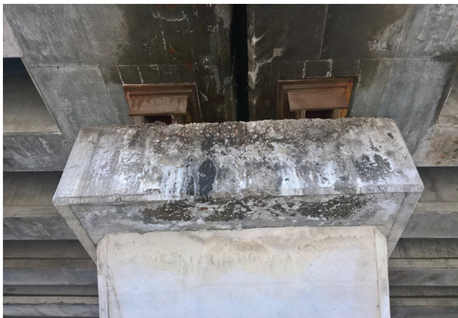
Fig. 2 - Degradarea banchetei cuzineților (exfolieri) prin expunere la atacul din îngheț-dezgheț cu sare (XF4) datorat neetanșeității rostului. Apa încărcată cu cloruri saturează betonul (XC4) producând coroziunea prematură a armăturilor (XD3). Fotografia a fost făcută la aproximativ 10 ani de la darea în exploatare.
