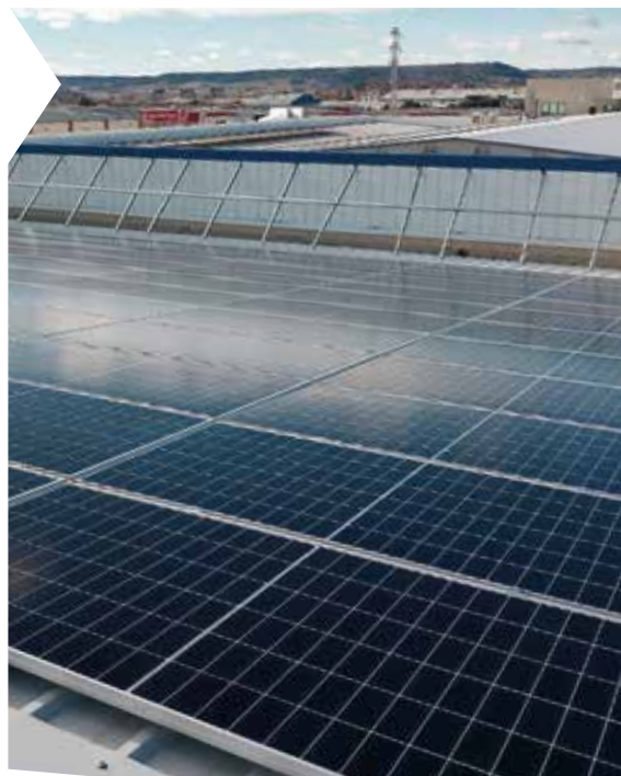
Placas solares instaladas sobre la Sala de Despiece ubicada en Palencia
