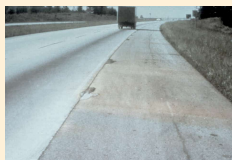
SE DEBILITA LA BASE DEL PAVIMENTO
