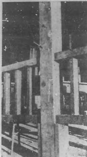
Esta columna de madera, en el rincón donde se encontraba el presidente Remón cuando fue atacado, quedó totalmente llena de impactos.
