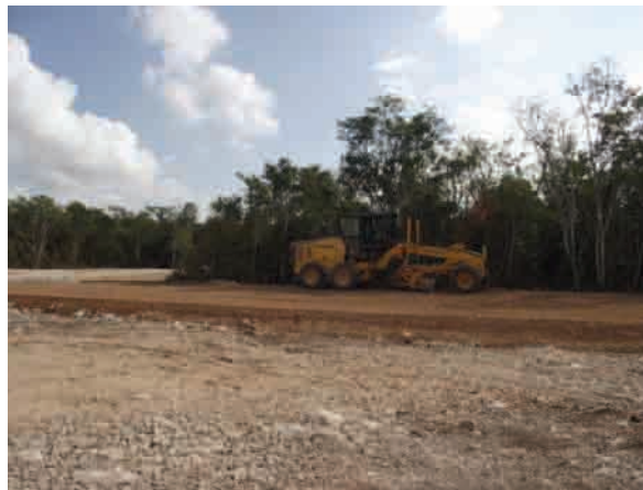
Figura 2. Imagen de las áreas desmontadas del predio donde se puede observar su topografía plana.
