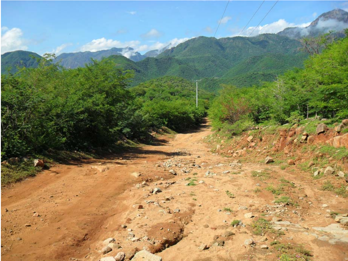
Fig. V.1. Condiciones del Camino.
