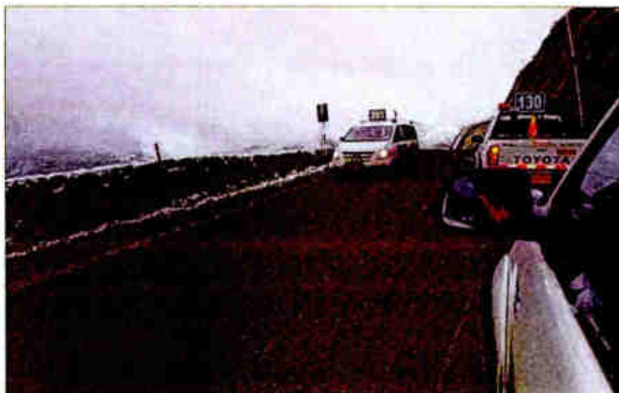
FOTOGRAFÍA 3-1. La falta de profundidad, perfil, pendiente y capacidad de drenaje ha ocasionado un exceso de agua sobre la vía.
