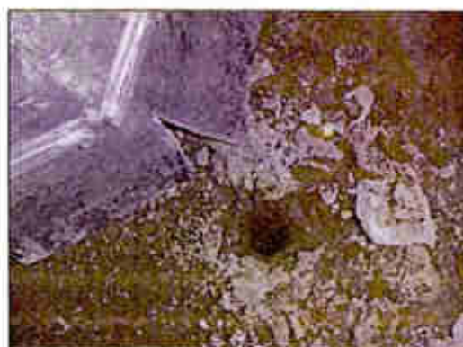
FOTOGRAFÍA 3-7. Orificio de Acceso Perforado Previamente a Través de la Estructura de la Calzada.
