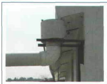
Figura 10. Soporte de línea de conducción.
