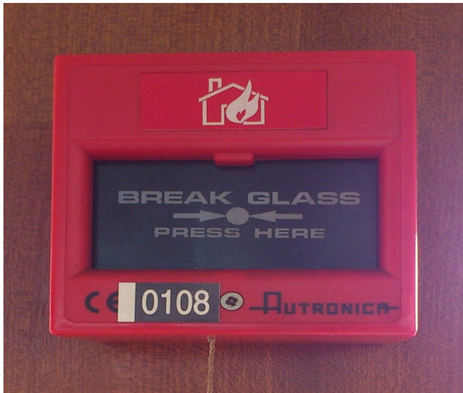
SISTEMA DE DETECCION DE INCENDIOS
