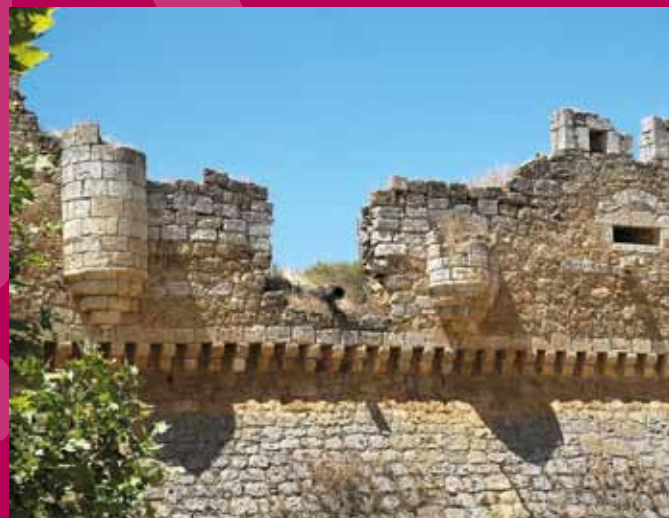
Detalle de la zona más deteriorada y con peligro de derrumbe.
