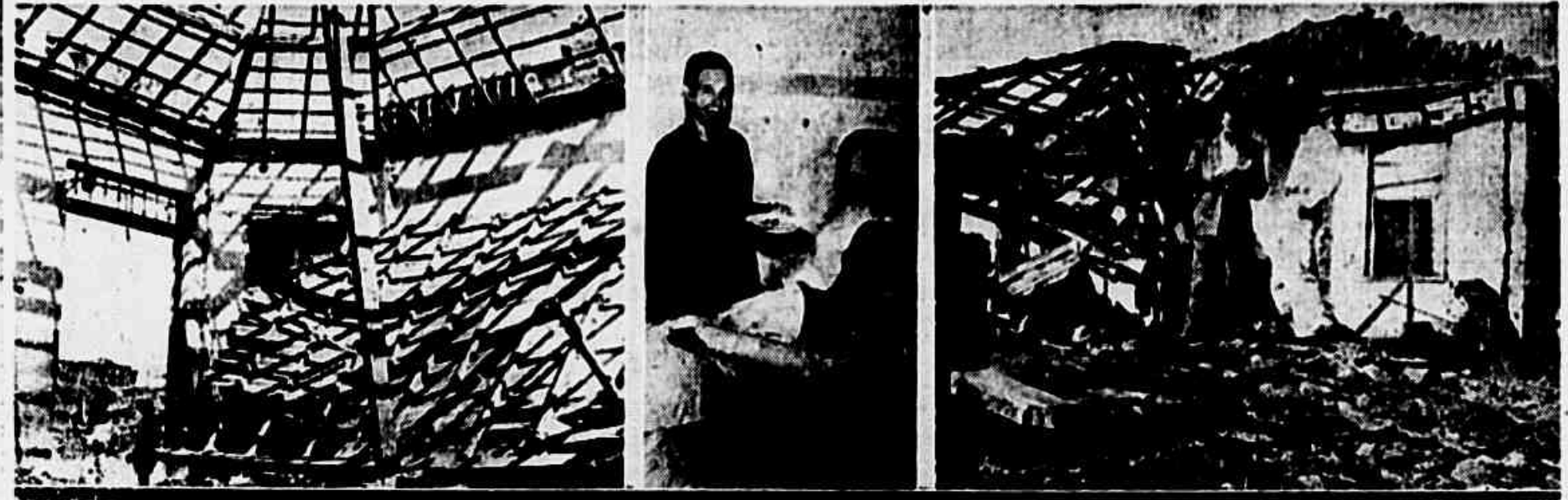
TRES ASPECTOS DO DESABAMENTO OCORRIDO NA CIDADE PAULISTA DE MIRANDOPOLIS. ENTRE DOIS ASPECTOS DE UMA CASA DESTELHADA, APARECE UM DOS QUE ESCAPARAM COM VIDA, NO LEITO DO HOSPITAL, RECEBENDO ALIMENTAÇÃO.
