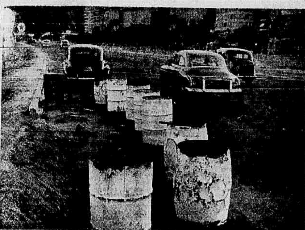
Com as chuvas, o asfalto (provisório) da nova pista do Flamengo sofreu muitas avarias, o que provocou reclamações de motoristas.
