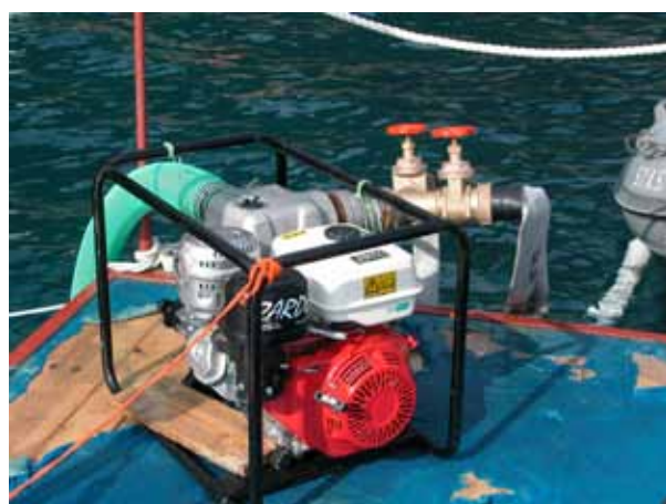
Fig. 61: Compresor utilizado para el aspirador a aire y el a agua
