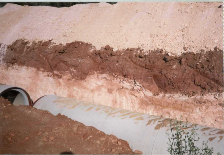
DR-9195.- Obras del regadio Genil Cabra, en el Cortijo de Pata de Mulo, en la zanja de techo a muro se observan: pequeño glacis de cobertera, costra calcárea Hojosa y calizas pulverulentas lacustres ? (17).
