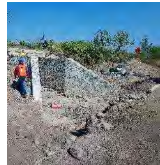
Ilustración 36. Construcción de las obras de drenaje; prolongación del puente con material de mampostería.
