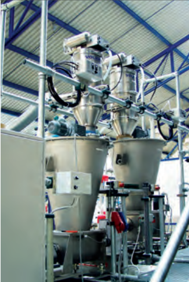
Dos transportadores por vacío para alimentación gravimétrica por pérdida de peso.
