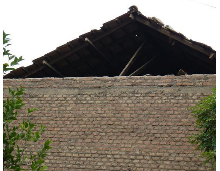
Desplome de antetecho en 2º piso. Sismo del 27 de febrero de 2010. Conjunto Elías de la Cruz. Imagen propia.
