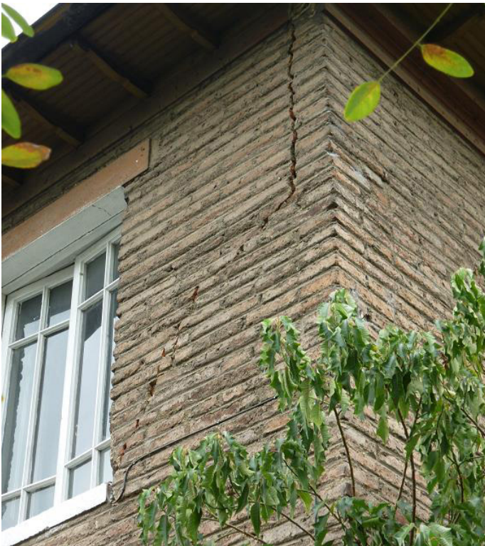
Dstrucción del empalme de muros. Sismo del 27 de febrero de 2010. Conjunto Elías de la Cruz. Imagen propia.
