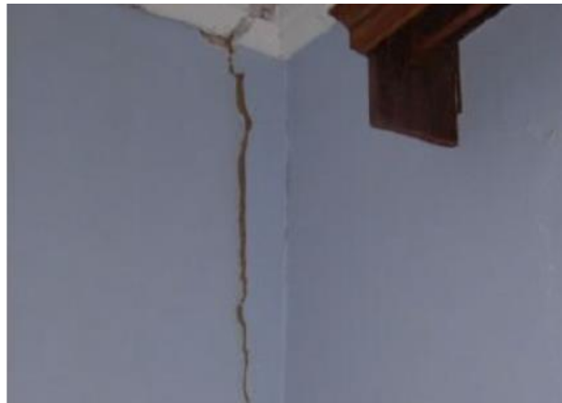
Figura 4. Grieta vertical superior en un muro interior de adobe.
