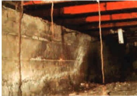
Figura 18. Túneles elaborados por termitas subterráneas, el cual contiene humedad permanente debido a la falta de ventilación bajo la plataforma.
