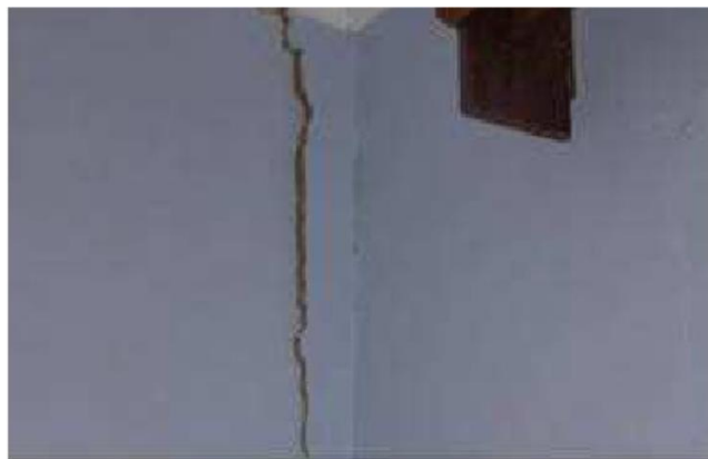
Figura 11. Grieta producida por asentamiento de terreno.
