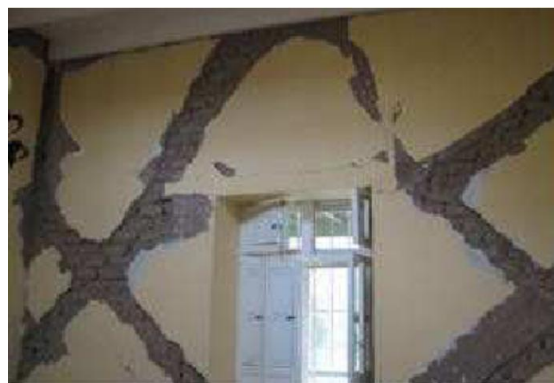
Figura 7. Grietas diagonales por fuerza cortante en el plano de un muro de adobe.
