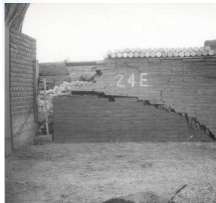
Figura 6. Grieta por combinación de volteo lateral y cortante en el plano de un muro de adobe.
