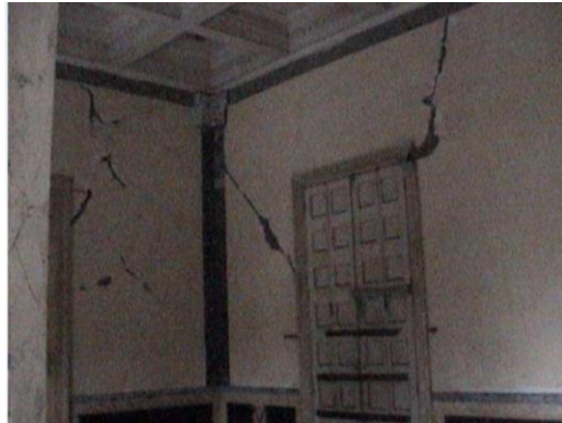
Figura 8. Grietas cerca del vano de una puerta en una construcción de adobe.
