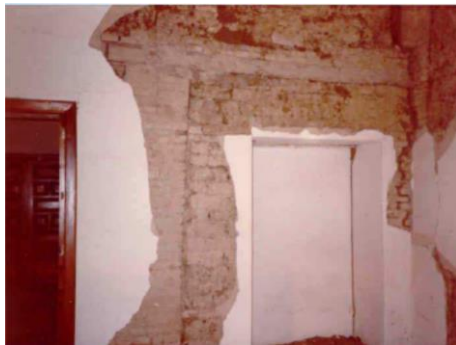
Figura 10. Desprendimiento del mortero de cemento y mezcla de ladrillo con adobe.
