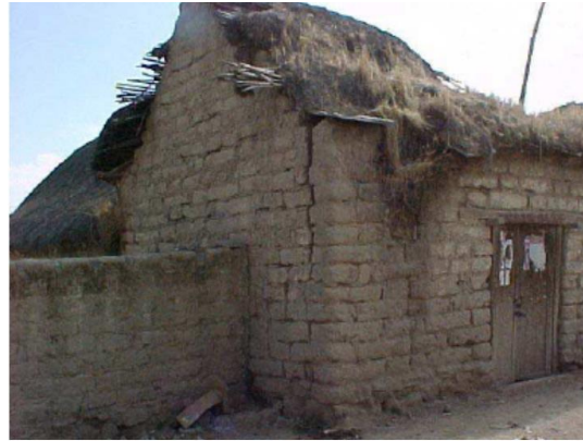
Figura 5. Agrietamiento en la parte superior de las esquinas de una construcción de adobe.
