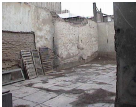
Figura 2. Erosión en pared que ha perdido el recubrimiento.
