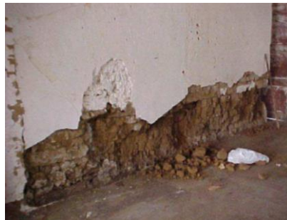
Figura 1. Humedad en la parte baja de un muro de adobe con disminución de la sección transversal del mismo.
