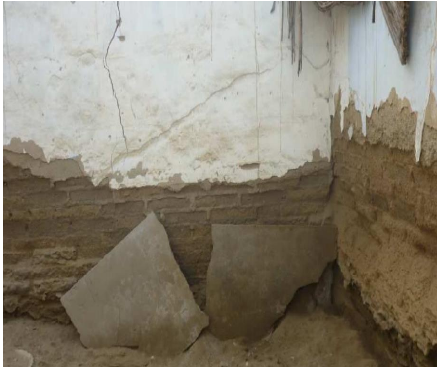
Figura 3. Hundimientos y rajaduras en edificaciones tradicionales.
