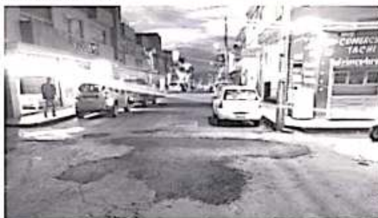
Trabajos de reparación en el parque Dámaso Cárdenas y acciones de restauración en las calles que fueron afectadas tras las lluvias atípicas del pasado 1 de noviembre.
