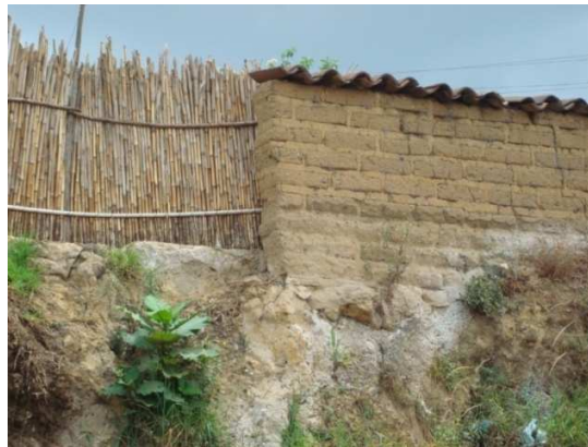
Figura 1. Ausencia de revestimiento en viviendas autoconstruidas de Guatemala, 2009.
