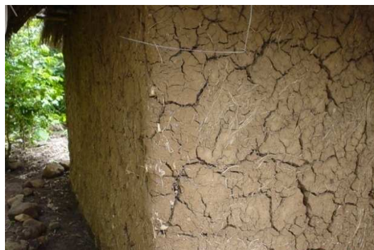
Figura 2. Defectos en los revestimientos en viviendas de Guatemala, 2009.
