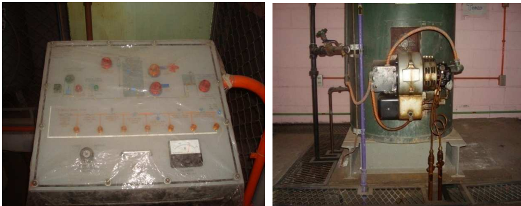
Figura 14. Tablero de Control de la Caldera (izquierda). Figura 15. Quemador de Diesel de la Caldera (derecha).
