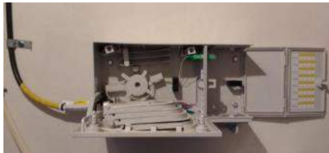
Imagen 1.8. CTO interior y Splitter 2. Detalle interior
