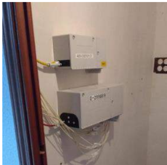
Imagen 1.6. CTO interior. Ubicación en recinto.
