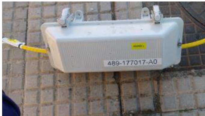
Imagen 1.4. Caja de Empalme, en su interior Splitter 1
