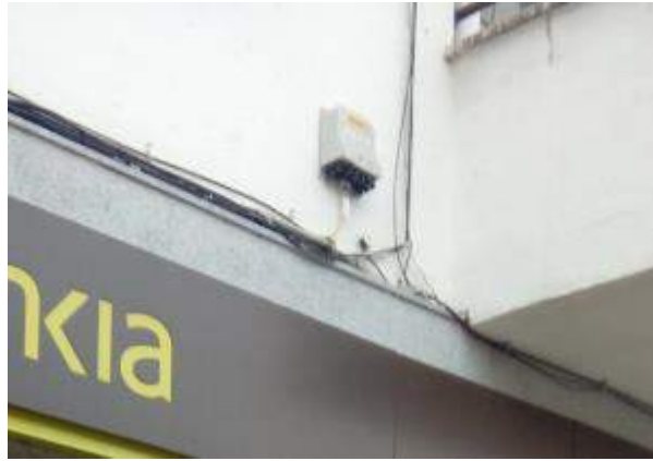
Imagen 1.7. CTO mini exterior 16P. Ubicación en fachada
