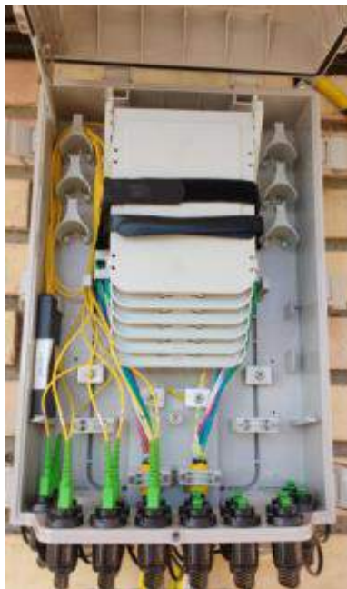
Imagen 1.6. CTO exterior 16P y Splitter 2. Detalle interior
