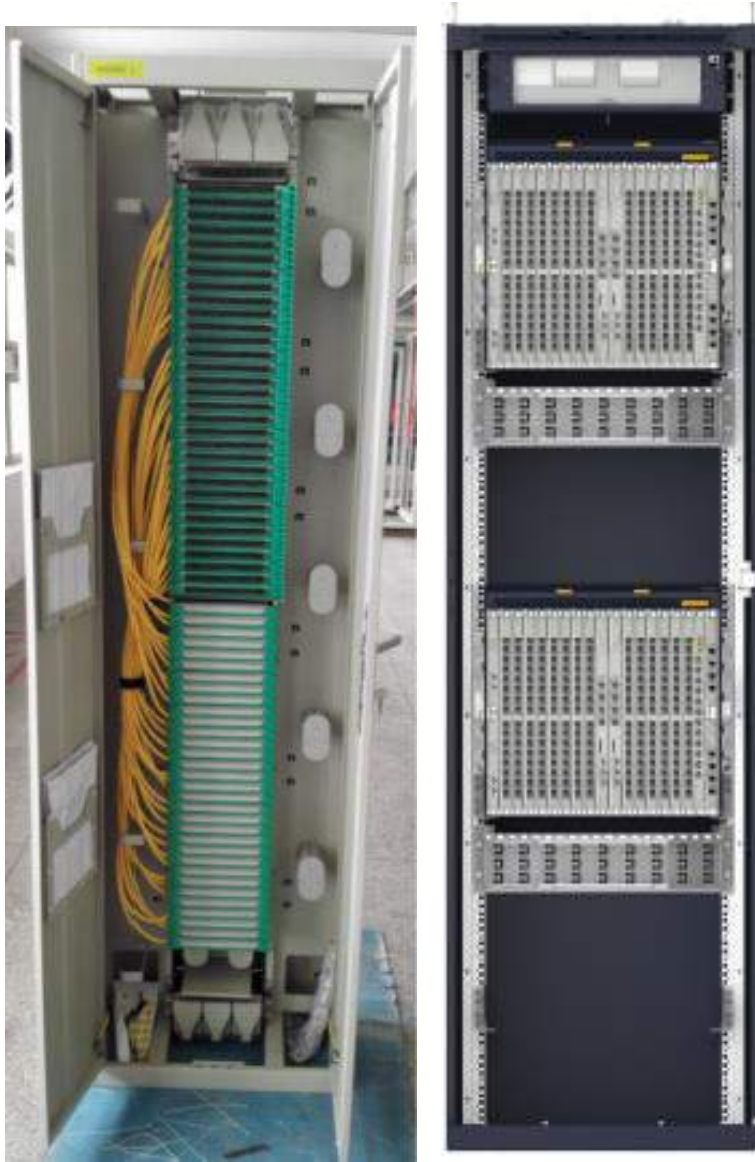
Imagen1.1: Izquierda Armario ODF, derecha armario con OLT
