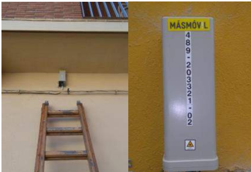
Imagen 1.9. CTO Multipuerto Exterior. Ubicación en fachada y detalle.
