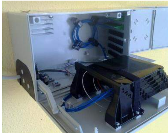
Imagen 3.7. Detalle Splitter CTO interior
