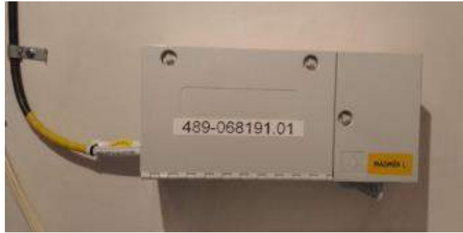
Imagen 1.7. CTO interior. Detalle exterior.
