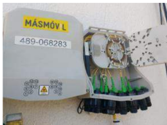
Imagen 1.8. CTO exterior 16P. Detalle interior
