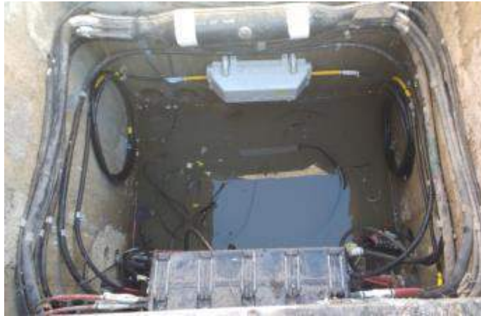
Imagen 1.3. Caja de Empalme, ubicación en arqueta
