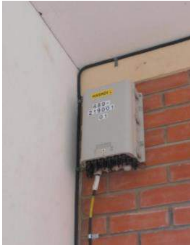
Imagen 1.5. CTO exterior 16P. Ubicación en fachada.
