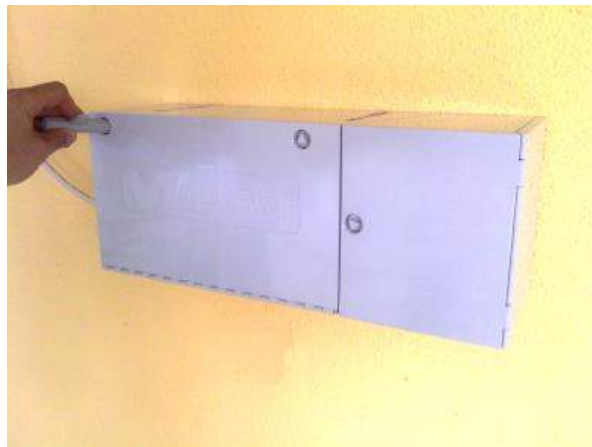
Imagen 3.8. Detalle exterior cerrada de CTO Interior
