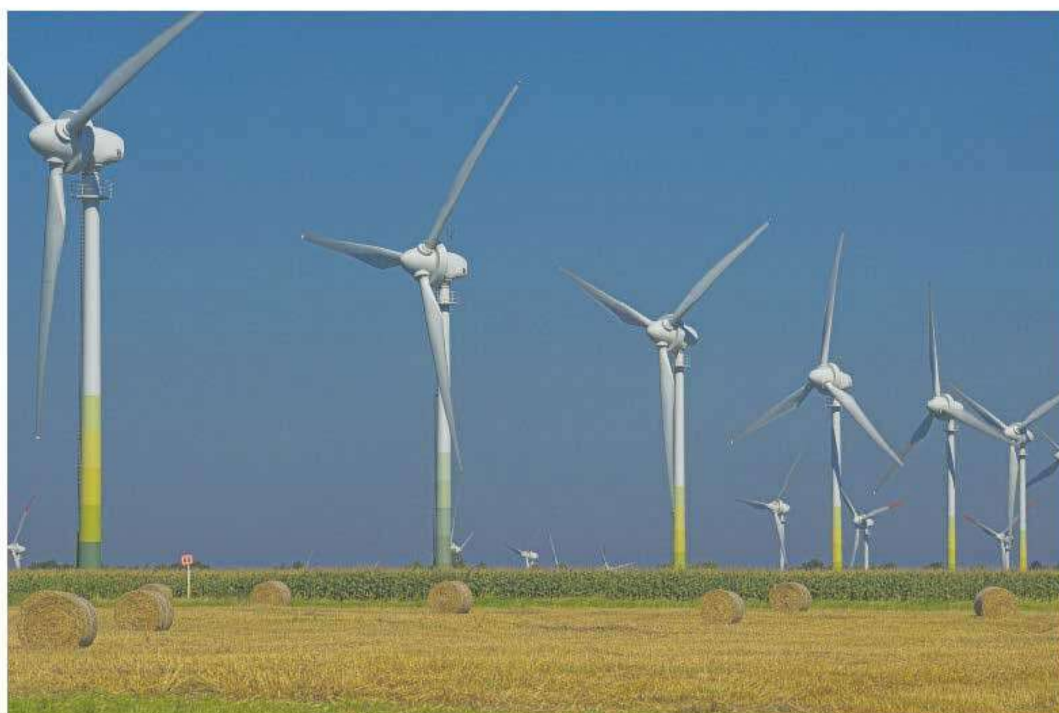
◆ Turbinas de viento en Alemania.
