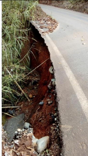
Foto 9. Pérdida de soporte de la banca.
