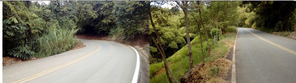
Foto 7. Pérdida de soporte de la banca en curva.
