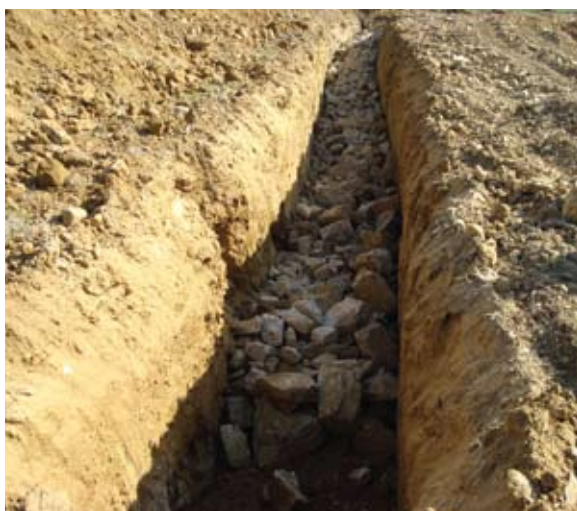
1. Drenaggio con sassi reperiti sul posto che, insieme alle "pignatte" in cotto, rappresenta la migliore soluzione (mentre i tubi corrugati e il tessuto-non tessuto si intasano velocemente)
