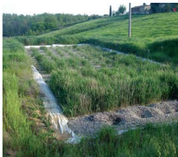
4. Nuovo impianto di fitodepurazione per lo smaltimento dei reflui di cantina
