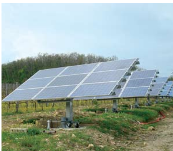
3. Pannelli solari (con inseguitore)
