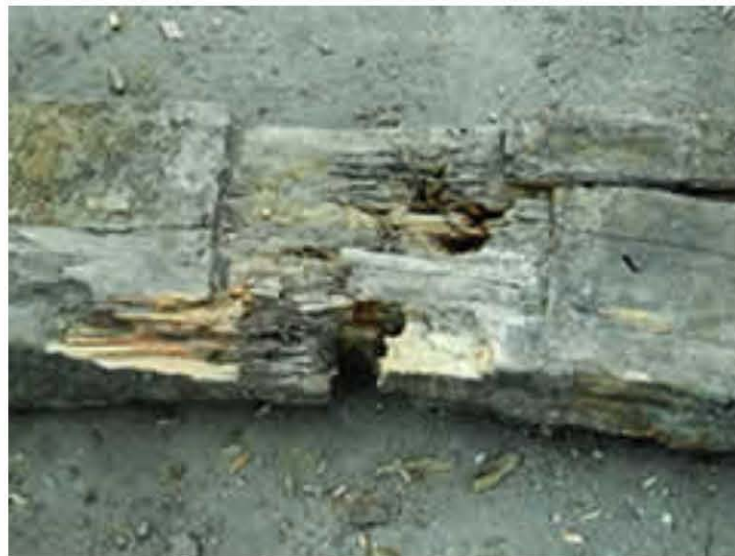
deterio de la madera en un puente en Chile en la región de Araucanía
